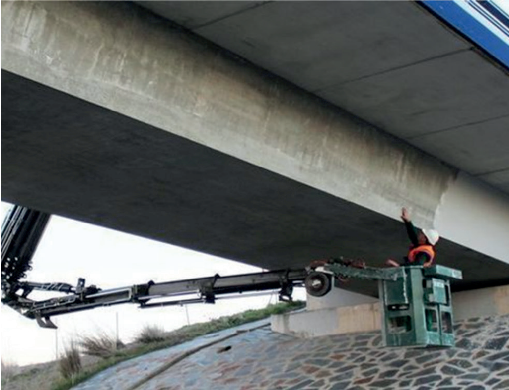
Imagen 3. Revisión de viga de viaducto en la AP7 por parte de un operario utilizando un camión con cesta. Además del riesgo de altura generado, esta operación, salvo que el fabricante lo indique expresamente, no se puede hacer, ya que las prolongas tienen una contra-flecha para contrarrestar la carga en punta. Si se colocan al revés, como es el caso de la fotografía, el efecto que produce es el contrario.
