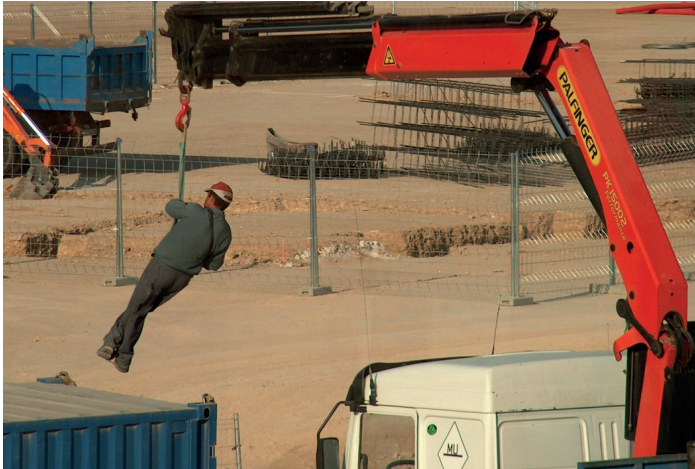
Imagen 11. Trabajador autónomo exponiéndose de forma imprudente a una grave situación de riesgo de caída de altura
