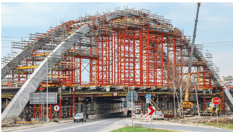
Figura 1. Ejecución de obra civil con torres de trabajo para cargas elevada. Fuente: Peri.
