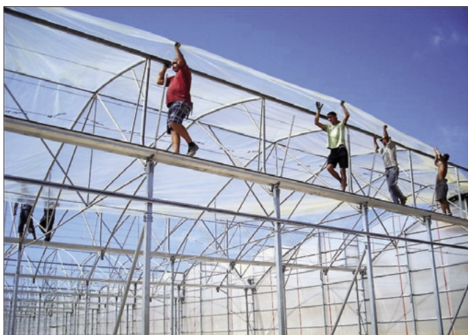
Foto 1. Situación de riesgo grave de caída de altura durante la instalación del plástico en la cubierta del invernadero.
