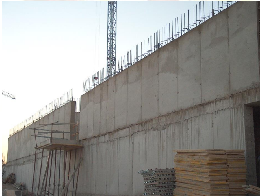
Muro sin proteger
