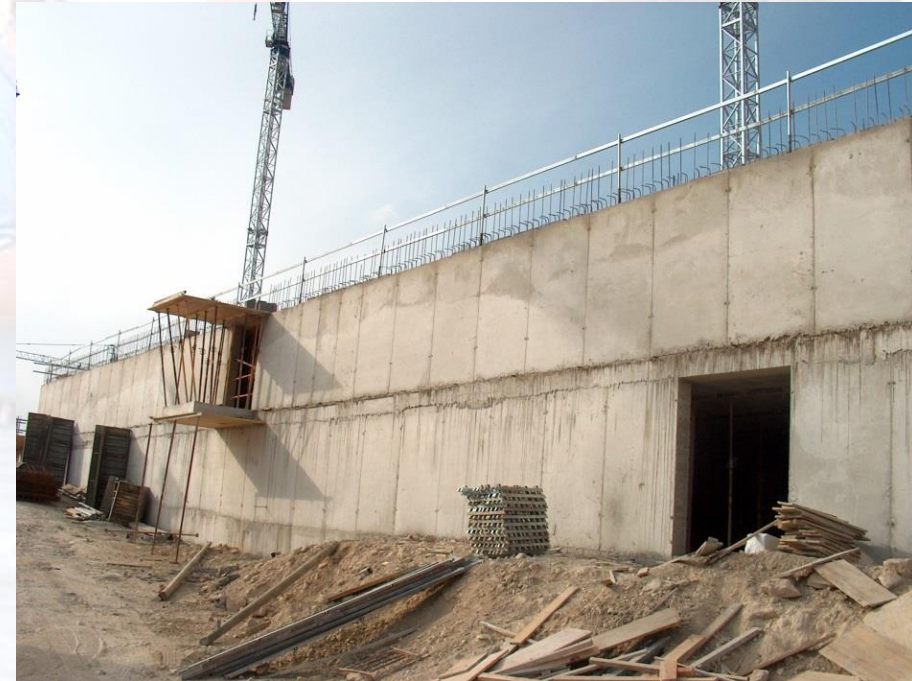
Muro protegido con el sistema
