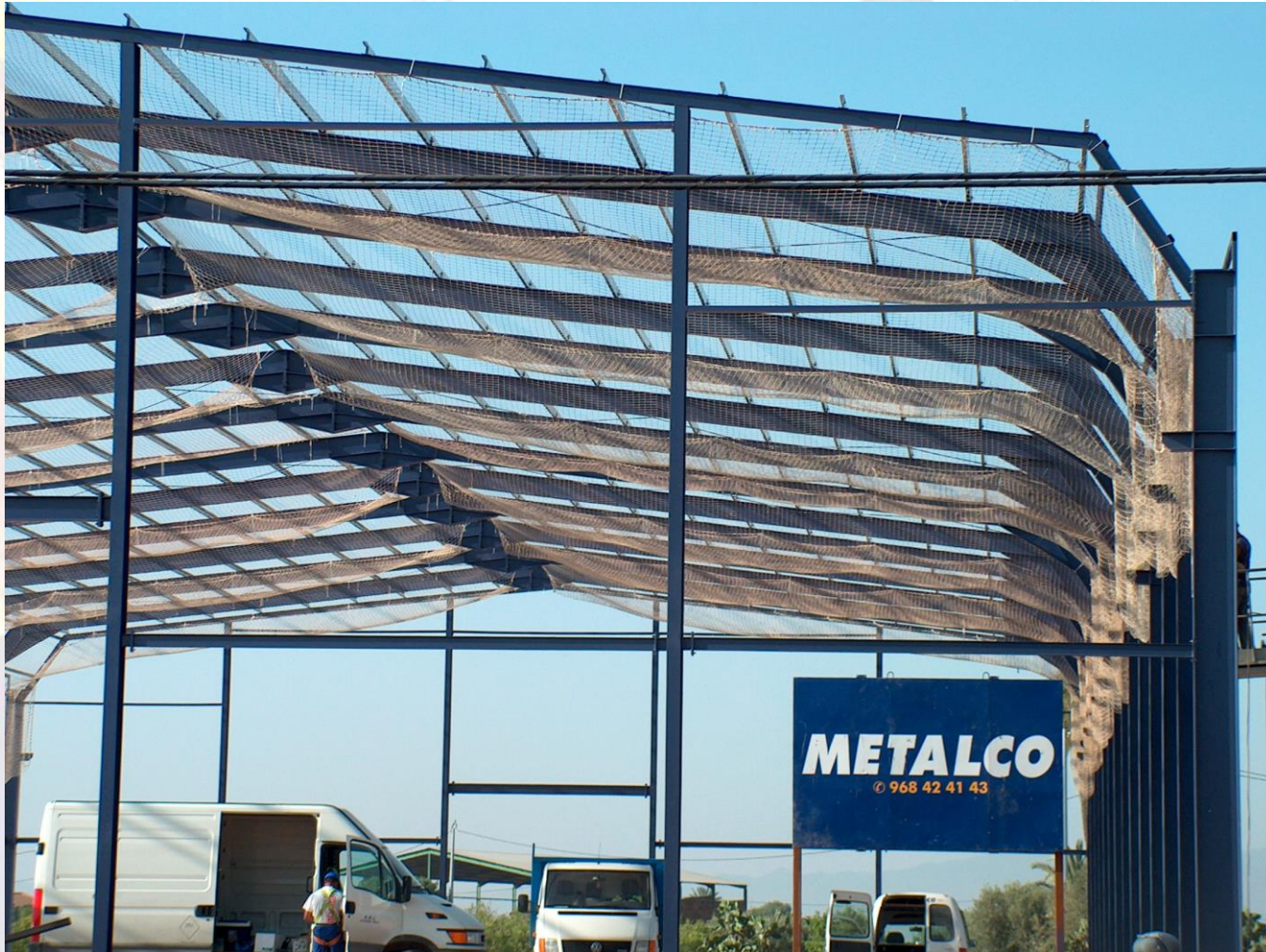
Caída interior protegida
