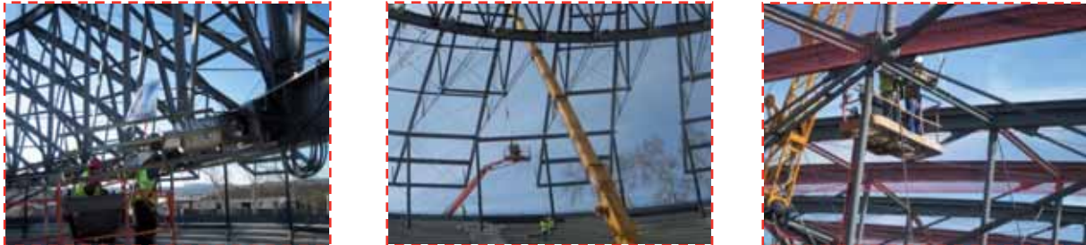
Detalle proceso de retirada equipos de izaje y finalización montaje estructura. Equipos y medios auxiliares empleados.
