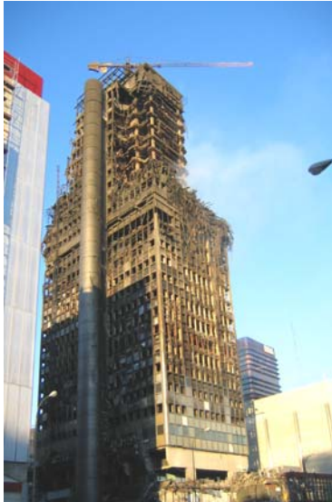
Edificio Windsor al día siguiente del incendio sufrido 13/02/2005.
