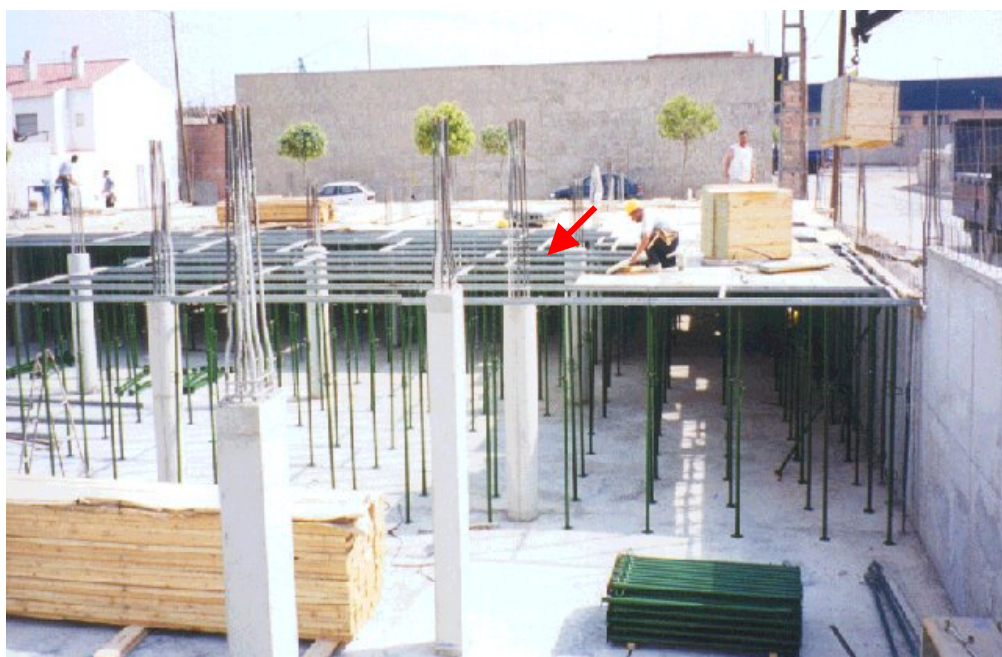
Figura 1 Proceso de colocación de los tableros en los encofrados continuos con un evidente riesgo de caída a distinto nivel.
