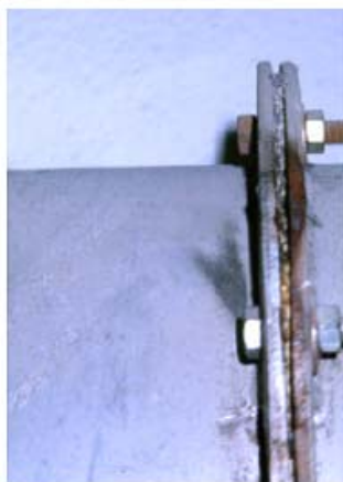
Juntas en canalizaciones de agua caliente
