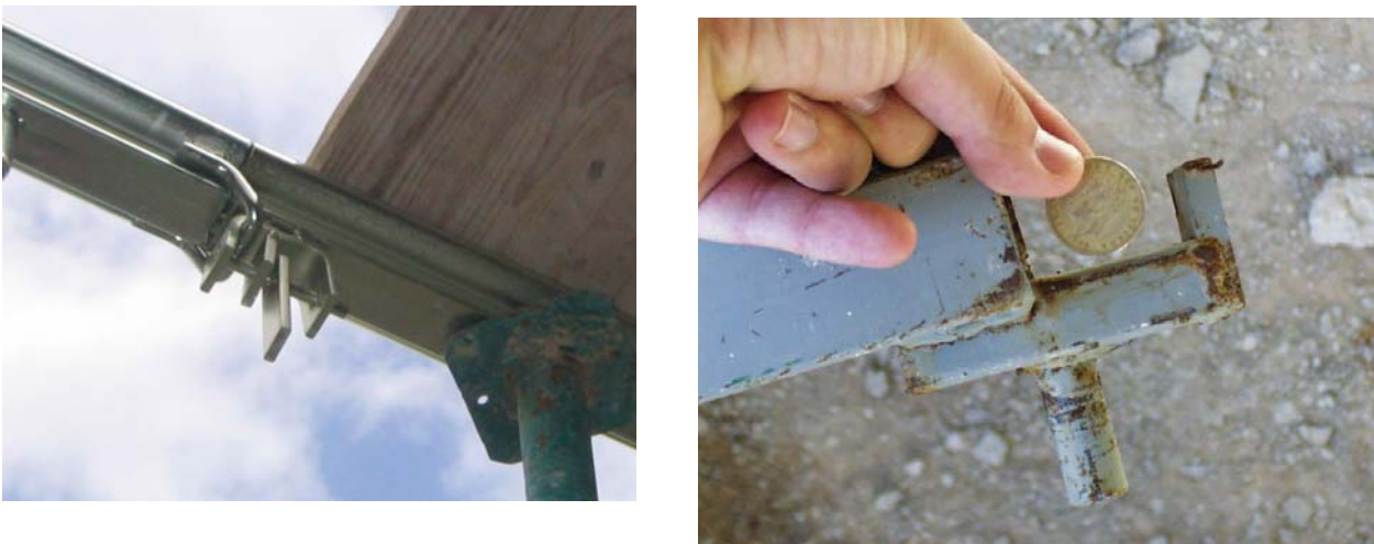
Figura 7 Dcha. Tipología de unión entre sopandas con elemento de seguridad. Izq. Tipología de unión entre sopandas con dudosa eficacia.
