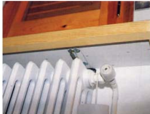
Placas de cartón-amiante en la protección de un foco de calor
