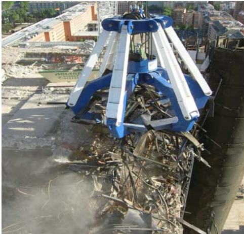
Uso de pulpo para retirada de material y escombros acumulados en planta 17.
