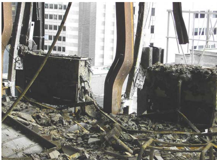
Detalle deformación de pilar en planta 9.
